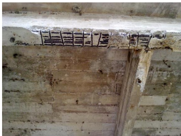
Figura 3a - Corrosão em viga primária da ponte 3.
