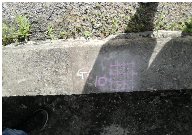
Figura 1b - Ensaio de avaliação da dureza superficial na viga primária da ponte 2
