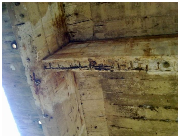
Figura 2b - Corrosão na viga secundária da ponte 2.
