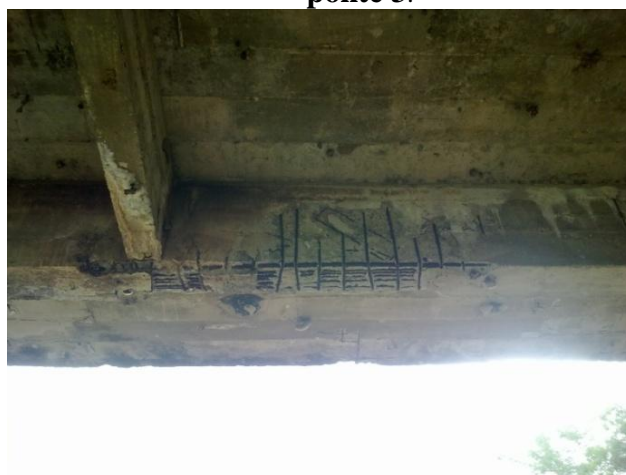
Figura 3c - Corrosão em viga primária da ponte 3.
