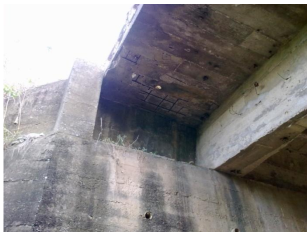
Figura 2a - Corrosão na laje da ponte 2.
