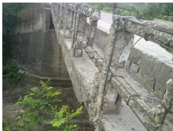
Figura 3b - Corrosão no guarda corpo da ponte 3.
