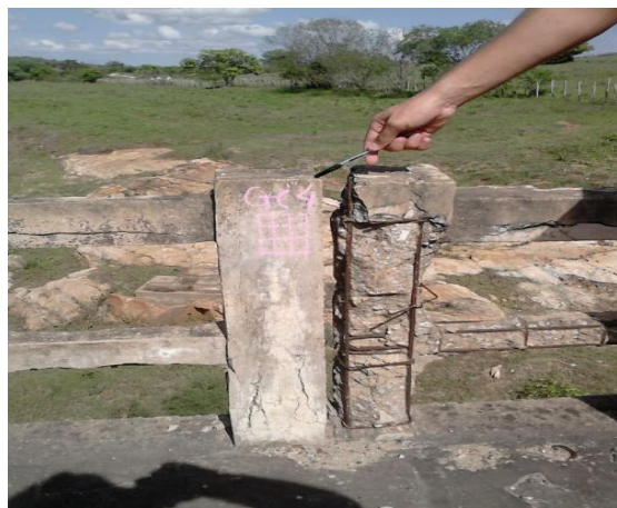
Figura 1a - Ensaio de avaliação da dureza superficial no guarda corpo da ponte 2.
