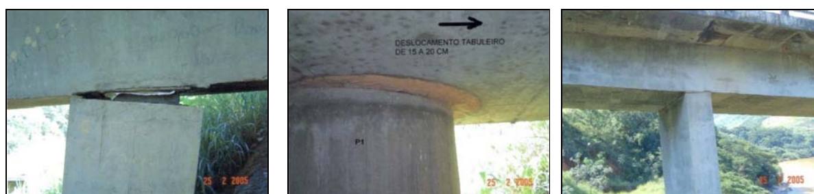
(a) Deslocamento e rotação do pilar P1.
