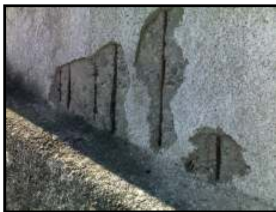
Fotos 1 : Vista da exposição e corrosão de armaduras na cortina na Rua Alzira Valderato no Sampaio.
