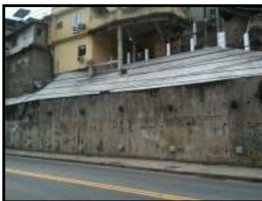
Foto 1: Vista da Cortina ancorada com ocupação irregular a montante
