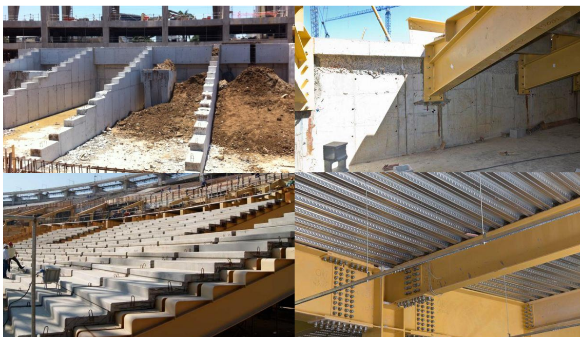
Figura 2 – Contrafortes durante a construção, detalhe da ligação da estrutura metálica no contraforte, as “vigas-jacaré” e degraus em pré-moldados e as lajes em “steel deck”
