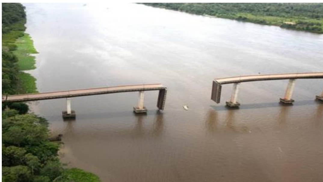
Figura 1 – Panorama aéreo da ponte após colisão. (Fonte: Antônio Silva/Agência Pará Site: http://g1.globo.com/pa/para/noticia/2014/03/ponte-da-alca-viaria-ficara-seis-meses-interditada-apos-acidente-com-balsa.html )
