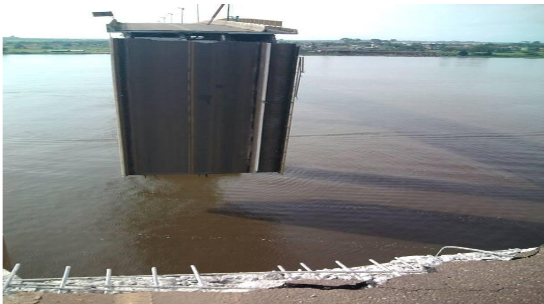
Figura 2 – Estado de comprometimento da ponte após colisão (Fonte: Divulgação/PRF Site: http://g1.globo.com/pa/para/noticia/2014/03/ponte-da-alca-viaria-ficara-seis-meses-interditada-apos-acidente-com-balsa.html )
