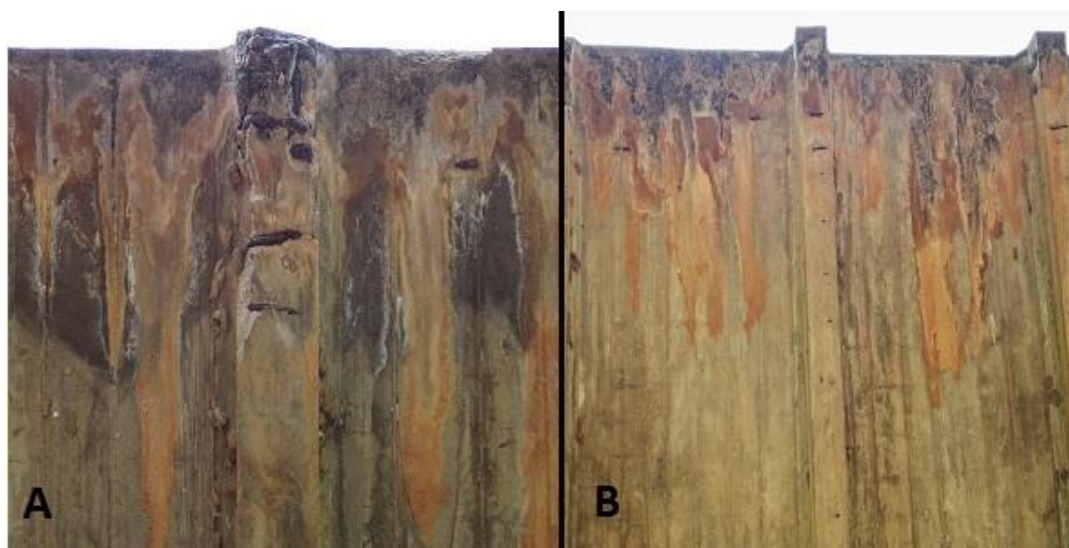
Figura 4 – Patologias no tabuleiro - A) Deslocamento/Corrosão B) Eflorescência (Fonte: autor).
