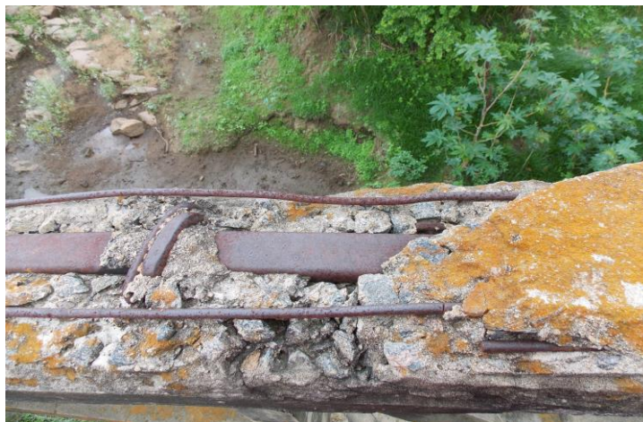
Figura 8 – Patologias no arco de sustentação (Fonte: autor).
