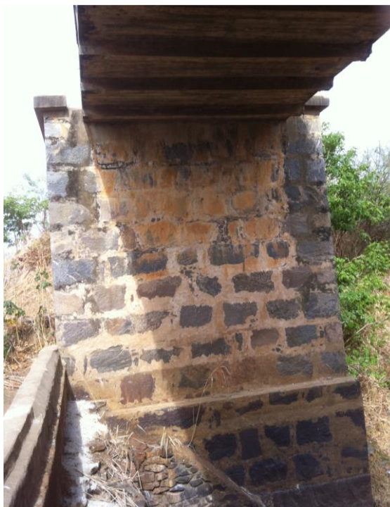
Figura 3 – Manchas na estrutura de encontro da ponte (Fonte: autor).
