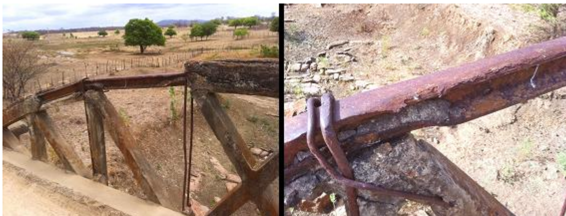
Figura 9 – Deterioração no arco de sustentação (Fonte: autor).
