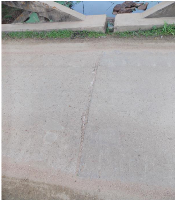
Figura 5 – Junta de dilatação obstruída (Fonte: autor).
