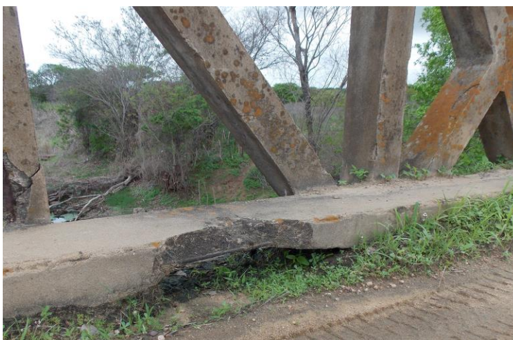
Figura 7 – Abertura na viga secundária (Fonte: autor).
