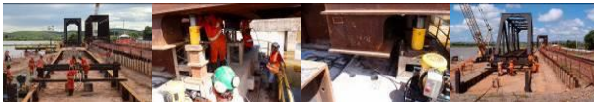
Figura 8: Trabalhos de abaixamento, montagem dos aparelhos de apoio e deslocamento da ponte antiga
