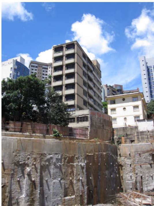
Figura 1 – Antes da ruptura da cortina
