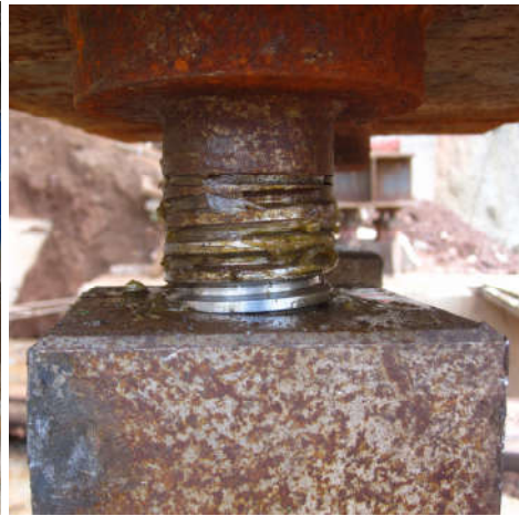
Figura 9 – Deslocamento da porca
