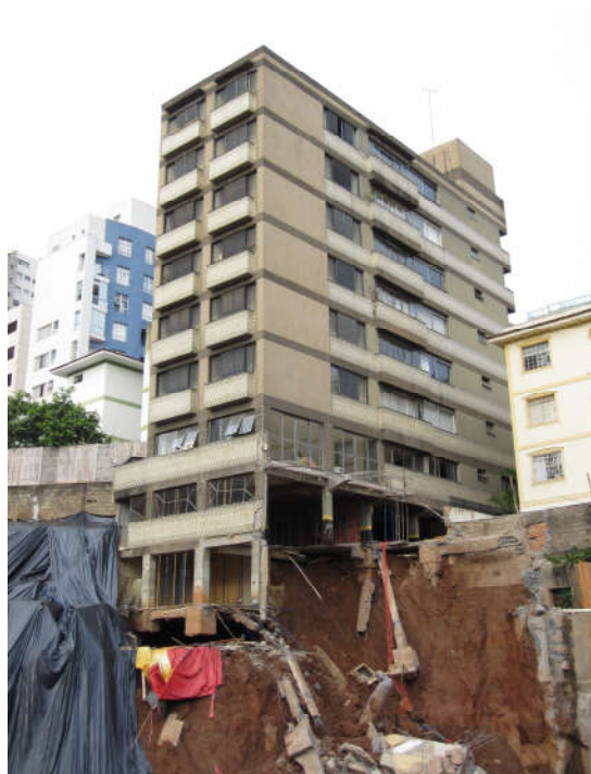
Figura 2 – Após a ruptura da cortina
