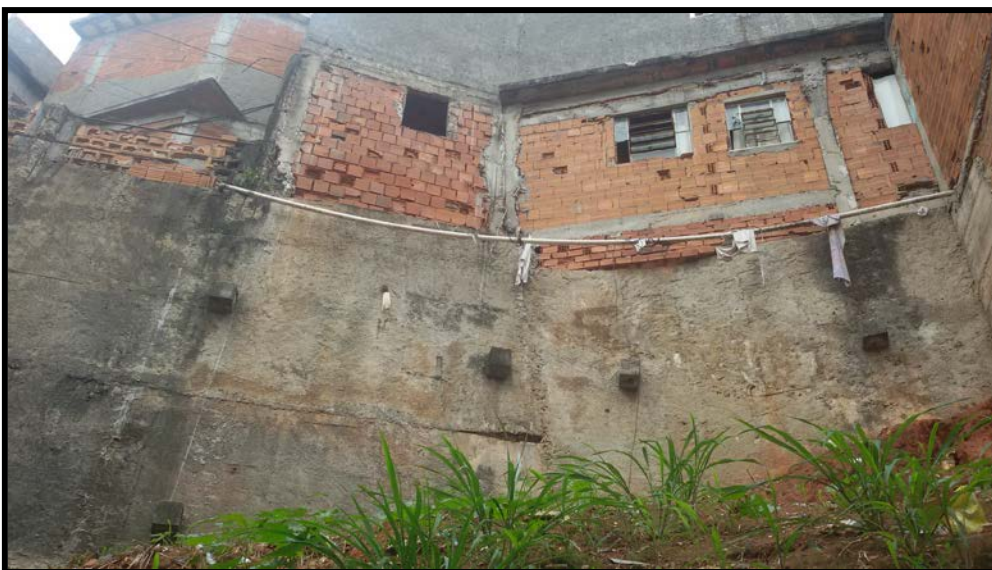
Figura 2. Vista da cortina ancorada na Comunidade do Tuiuti em Benfca onde o imóvel foi construído sobre o painel de concreto armado da cortina.
