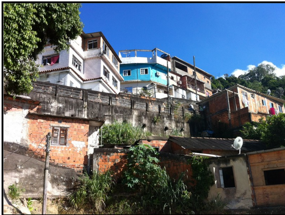
Figura 1. Vista da cortina ancorada na Comunidade Pereira da Silva em Laranjeiras, executada para arrimar uma rua de acesso.
