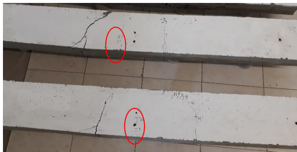
Figura 8: Fissuras após o término do ensaio
