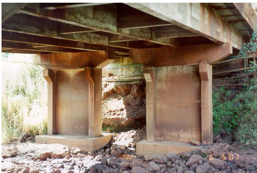
Figura 2 – Pilares e blocos de fundação antes do reforço
