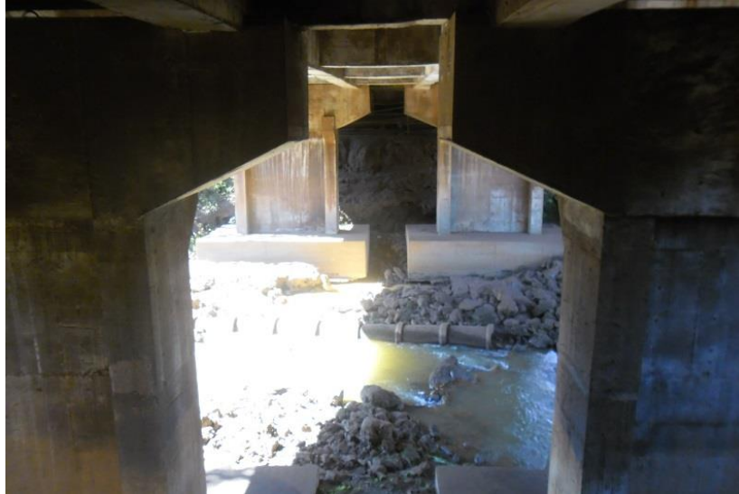
Figura 7 – Blocos de fundação já reforçados. O reforço foi executado em 2003. Foto tomada em 2016.
