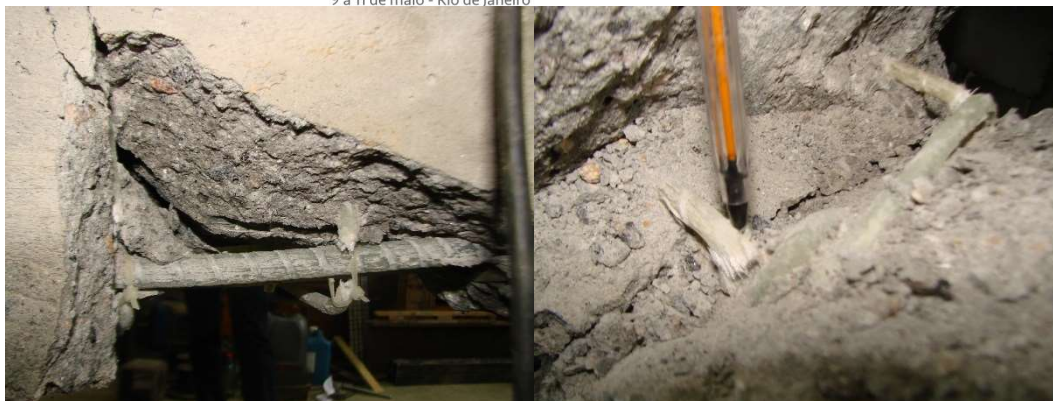
Figura 6 – À esquerda: rompimento dos estribos, e à direita: rompimento da armadura longitudinal superior, observados nas vigas do grupo 1
