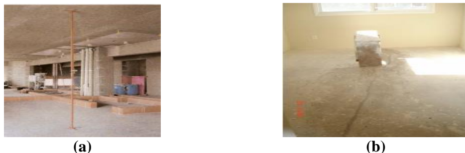
Figura 1 – (a) Utilização incorreta de reescoramento (b) fissura consequente de momento negativo devido a posição incorreta do escoramento (Vieira (2008)).
