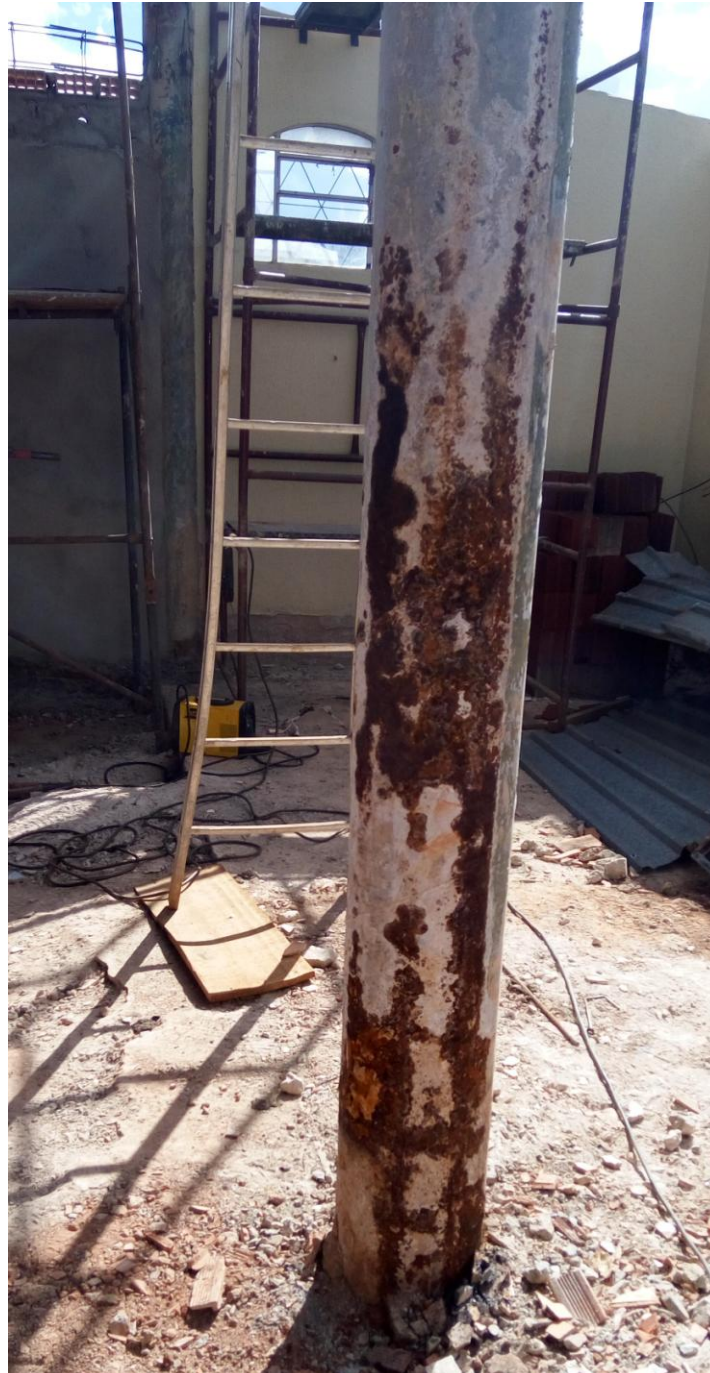
Figura 8 – Detalhe do pilar metálico com carepa de laminação e pites (Fonte: autor)
