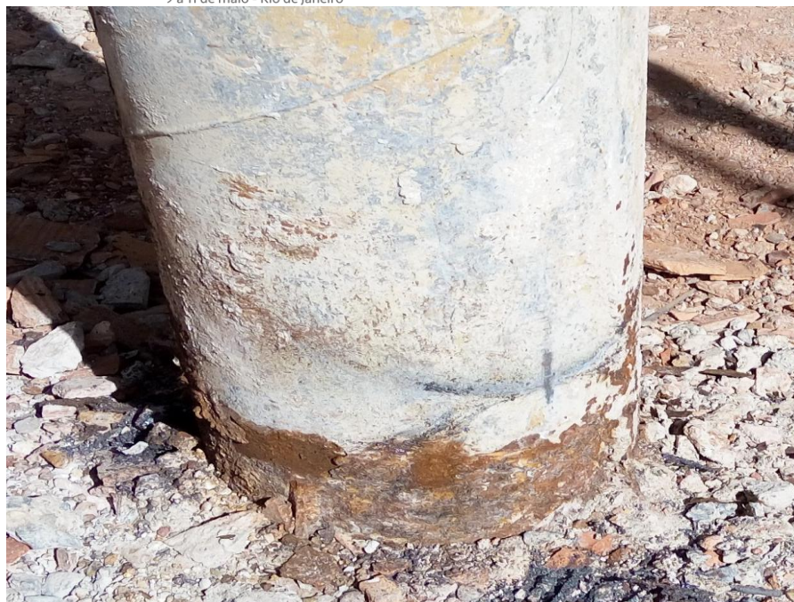
Figura 5 – Detalhe da base do pilar metálico ilustrando a carepa de laminação e pites (Fonte: autor)
