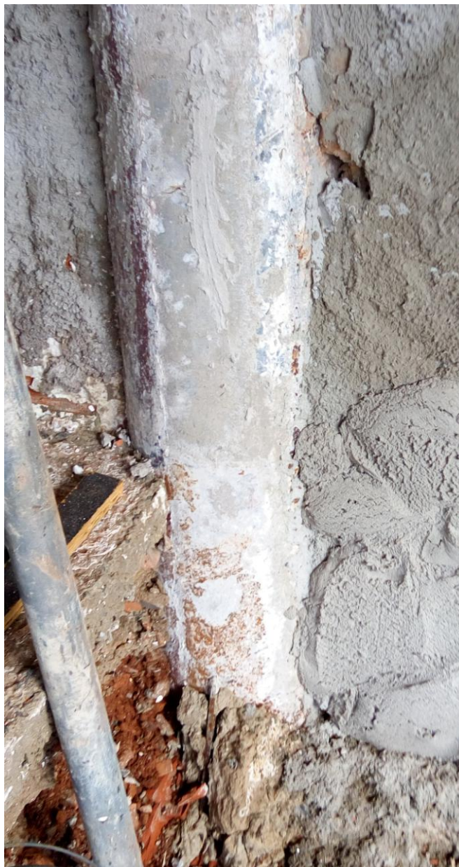
Figura 7 – Detalhe da base do pilar metálico com carepa de laminação e pites (Fonte: autor)
