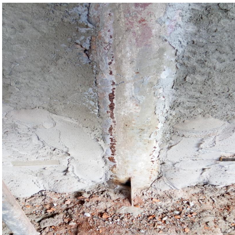
Figura 6 – Detalhe da base do pilar metálico com processo de corrosão localizada (Fonte: autor)
