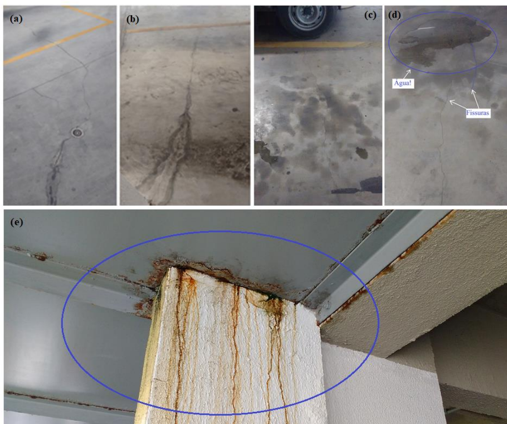
Figura 1 – Exemplos de manifestações patológicas em pisos de concreto.
