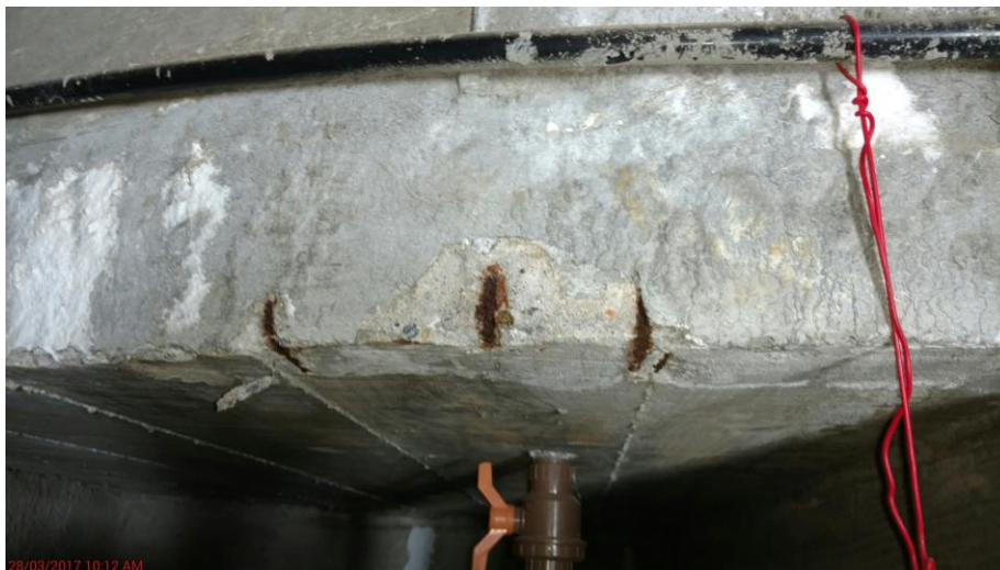
Figura 4 - Armaduras expostas e corroídas após a retirada do material solto
