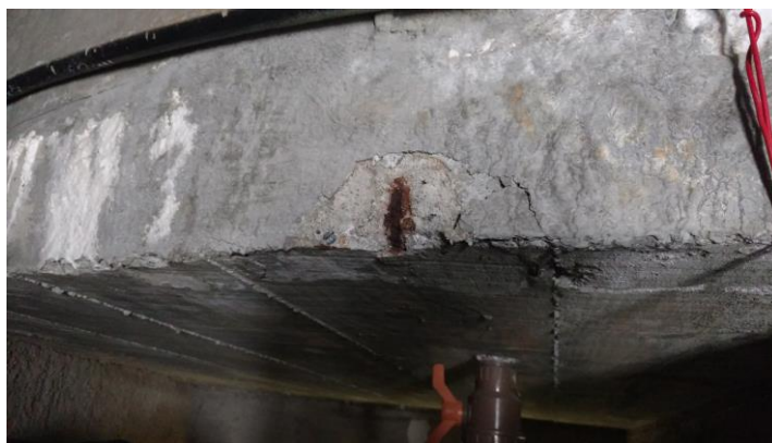
Figura 2 - Região do reservatório com material solto
