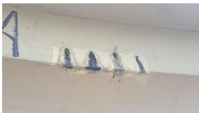
Figura 07 – Fenômeno de eflorescência na longarina do viaduto (Fonte: Autor)
