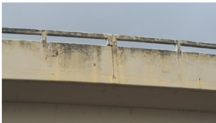
Figura 09 – Danos no guarda-corpo do viaduto (Fonte: Autor)
