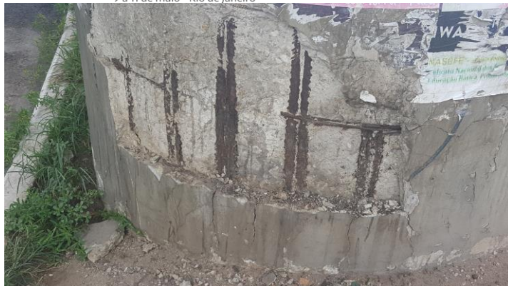
Figura 10 – Desagregação do concreto e corrosão das armaduras (Fonte: Autor)
