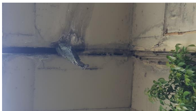
Figura 06 – Fenômeno de eflorescência e fissuras na área inferior do tabuleiro (Fonte: Autor)
