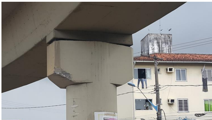
Figura 11 – Desagregação do concreto (Fonte: Autor)
