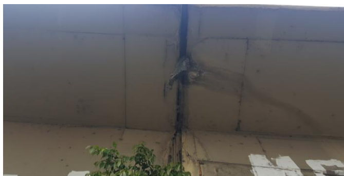
Figura 05 – Desgaste nas juntas de dilatação (Fonte: Autor)
