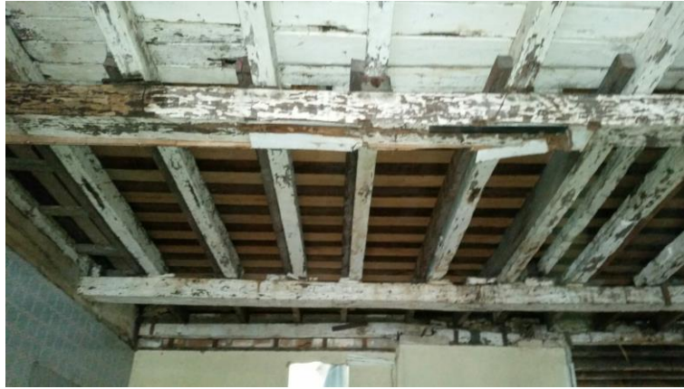
Figura 06 – Excesso de cargas nas vigas (Fonte: Autor)
