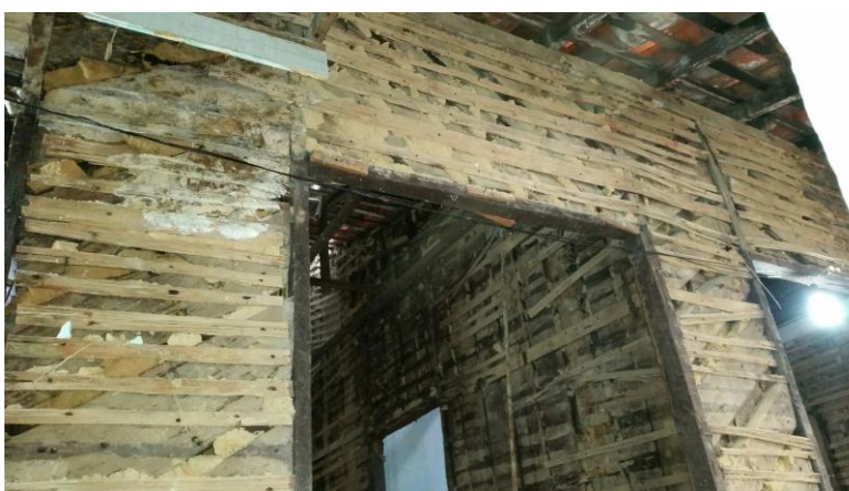
Figura 05 – Presença de fungos na madeira (Fonte: Autor)
