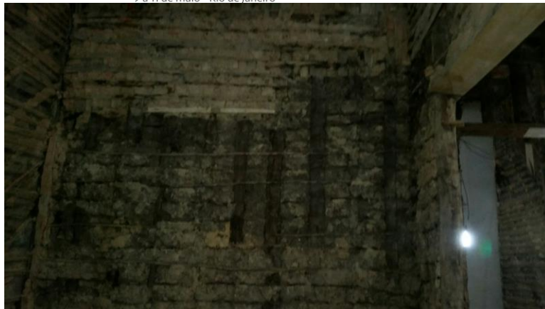
Figura 04 – Patologias na estrutura (Fonte: Autor)
