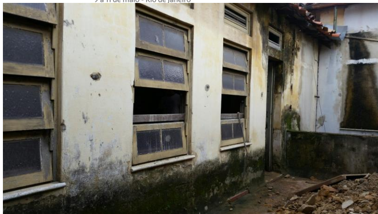
Figura 09 – Esquadrias danificadas (Fonte: Autor)
