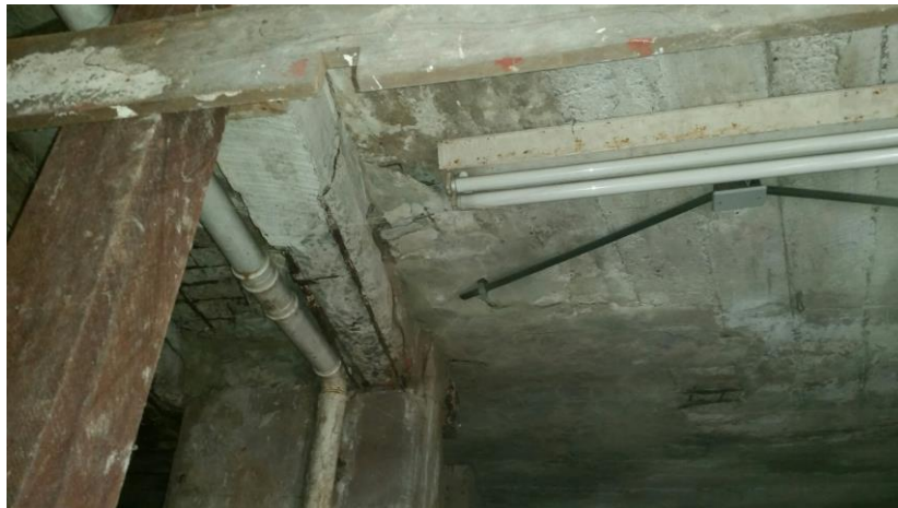
Figura 07 – Corrosão e desagregação do concreto (Fonte: Autor)
