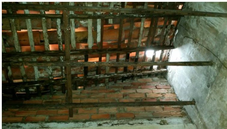
Figura 02 – Patologias na cobertura (Fonte: Autor)
