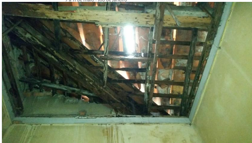
Figura 03 – Patologias na cobertura (Fonte: Autor)
