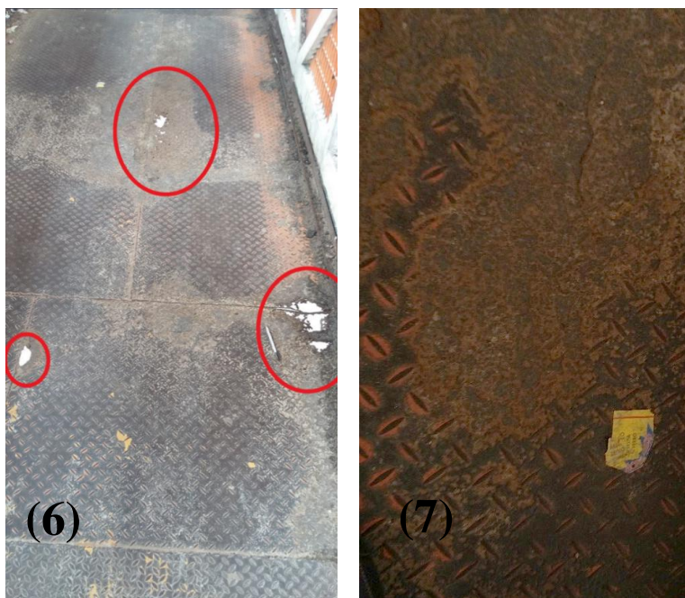
Figuras 6 e 7 – Estado avançado de corrosão uniforme no tabuleiro.
