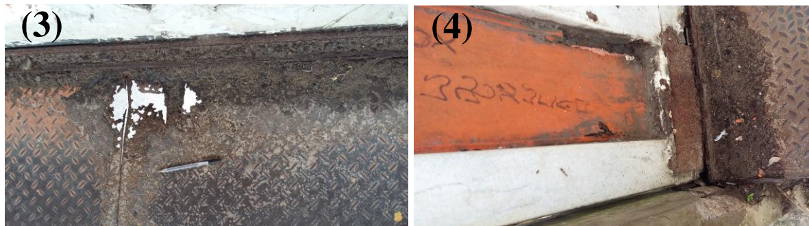
Figuras 3 e 4 – Pontos de corrosão encontrados no tabuleiro e no guarda-corpo metálicos.
