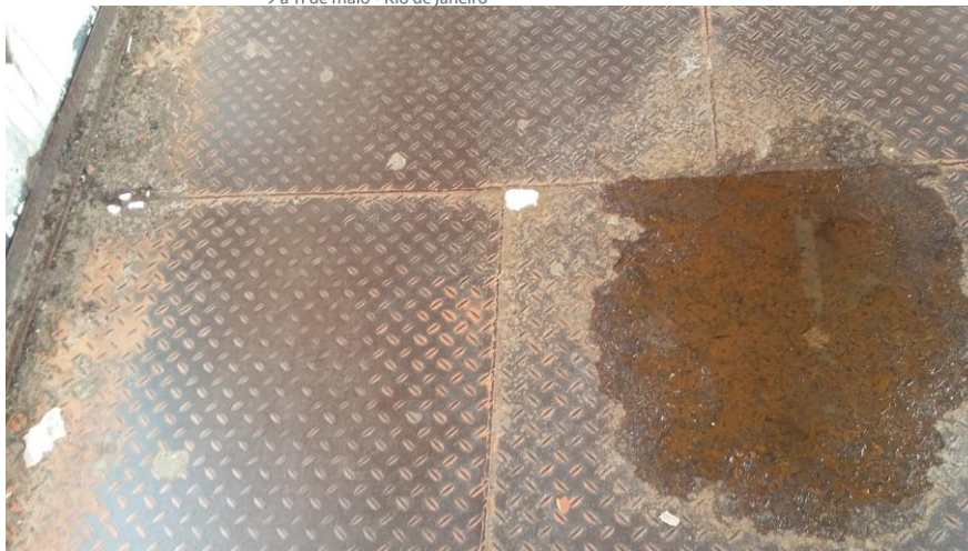
Figura 5 – Acúmulo de água no tabuleiro.
