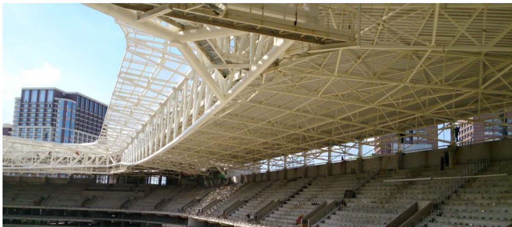
Figura 6 – Detalhe do apoio das tesouras radiais no anel interno e das mísulas com telhas translúcidas
