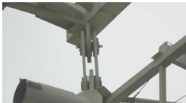
Figura 5 – Detalhe da ligação entre a extremidade da treliça principal com o anel interno por meio de um sistema de pinos e olhais
