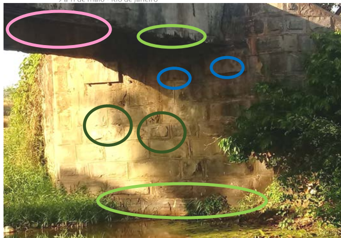
Figura 5 – Presença de ambiente com grau considerável de sulfetos. Fonte: Autores (2018)
