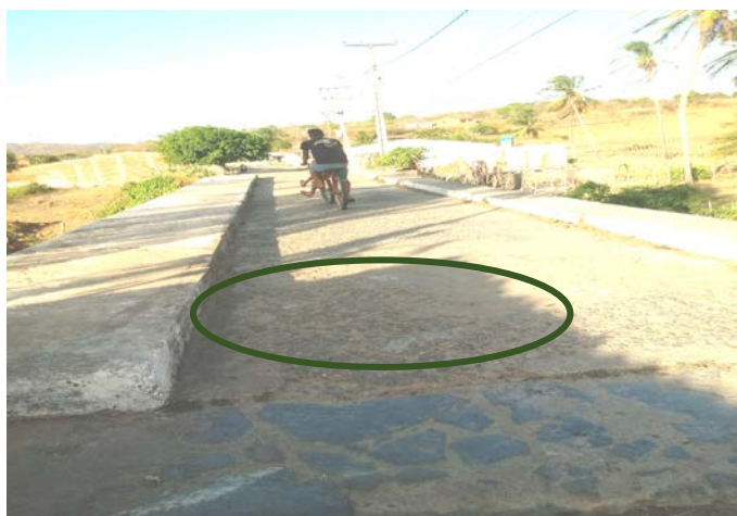
Figura 5 – camada superior do pavimento deteriorada. Fonte: Autores (2018)
