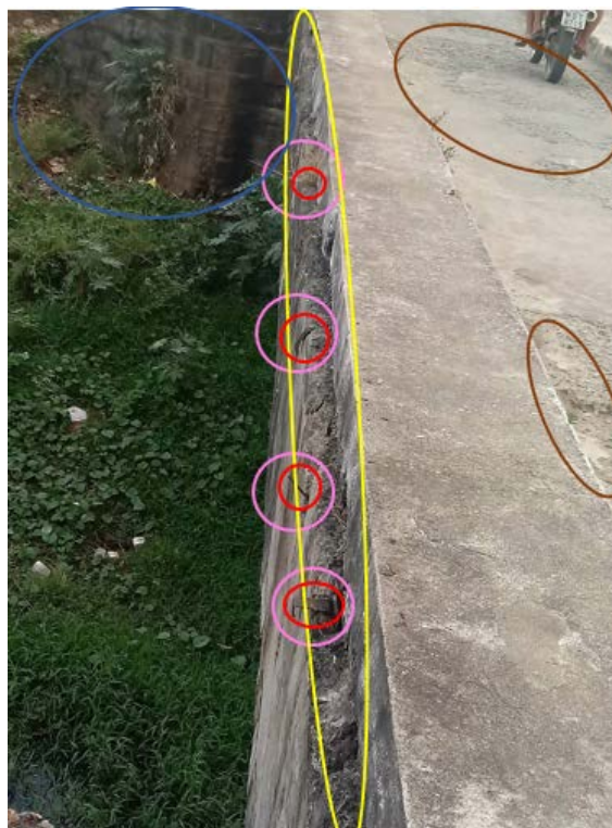
Figura 2 – Manifestações Patológicas da Estrutura vista lateral-superior (canto esquerdo) Fonte: Autores (2018)
