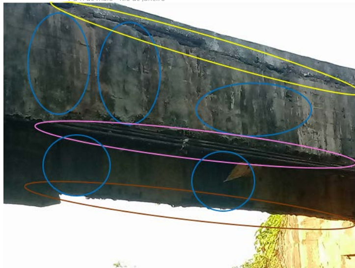
Figura 1 – Manifestações Patológicas na Lateral da Estrutura Fonte: Autores (2018)
