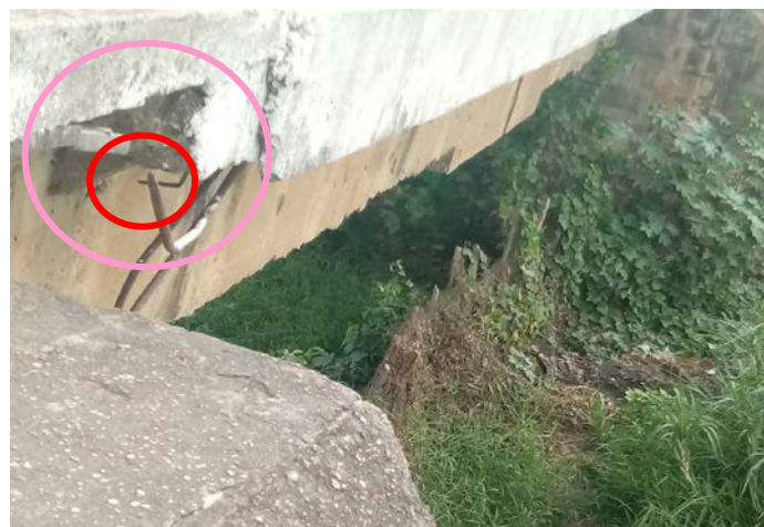
Figura 4 – Armadura exposta. Fonte: Autores (2018)
