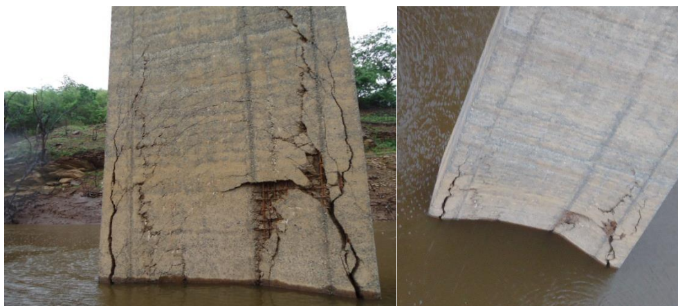
Figuras 3 e 4 - Face danificada do pilar P3
