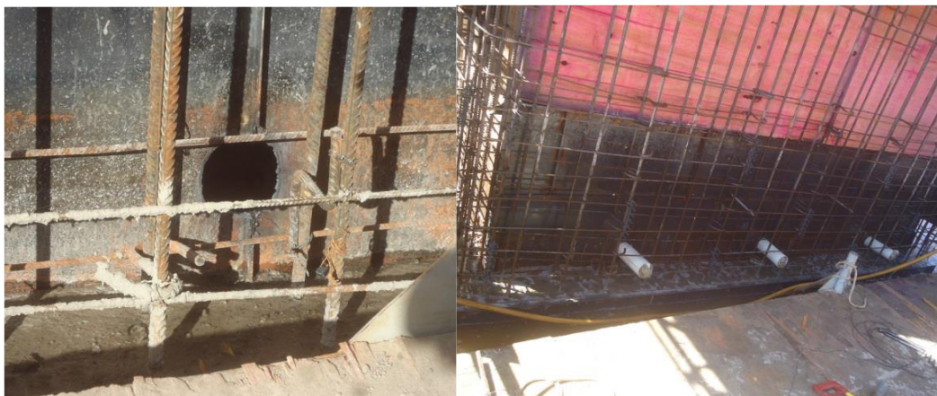
Figuras 14 e 15 - Perfuração para colocação dos drenos e tubos posicionados nas fôrmas na cota 3,40m
