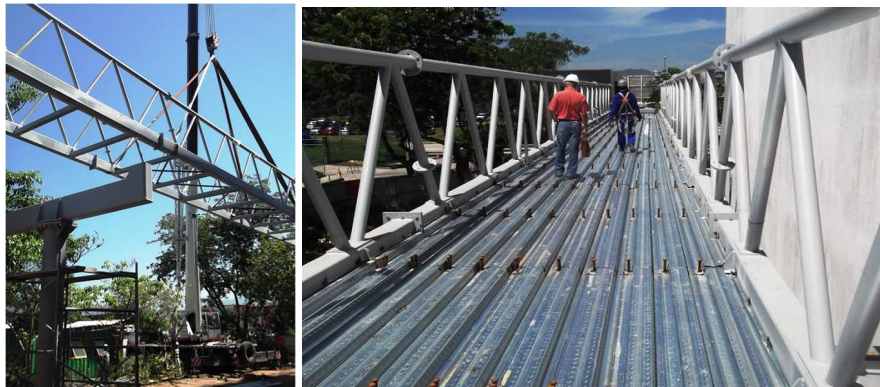
Figura 14 – Montagem das treliças e vista da estrutura de aço da Via Elevada já com o deque de aço montado e pronta para receber a concretagem da laje.
