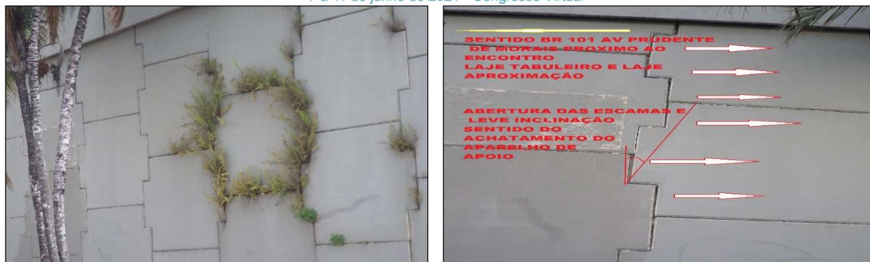
Figura 7 – Taludes/Terras Armada manifestações patológicas (Acervo dos autores (2020)).
