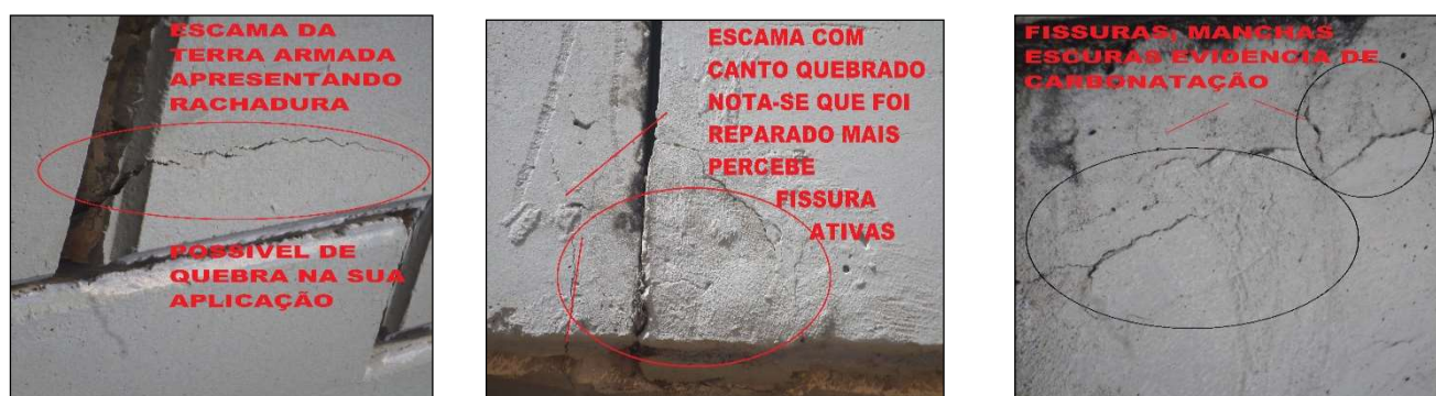
Figura 9 – Taludes/Terras Armada manifestações patológicas (Acervo dos autores (2020)).
