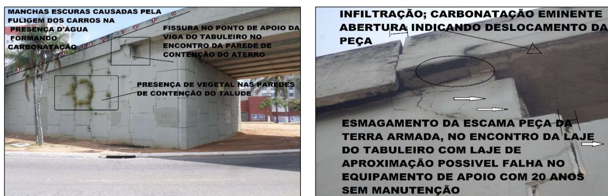
Figura 8 – Taludes/Terras Armada manifestações patológicas (Acervo dos autores (2020)).
