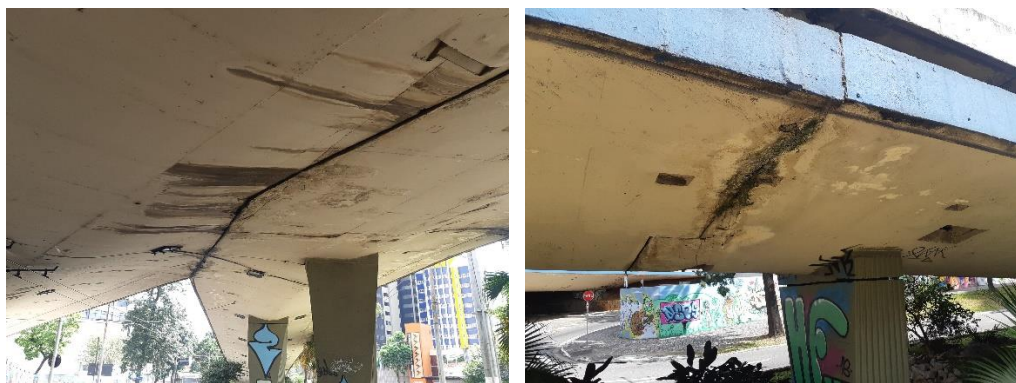
Figura 1 e 2 – Vista da Junta de dilatação do Viaduto Ângelo Gaiarsa-Santo André (Acervo autor)
