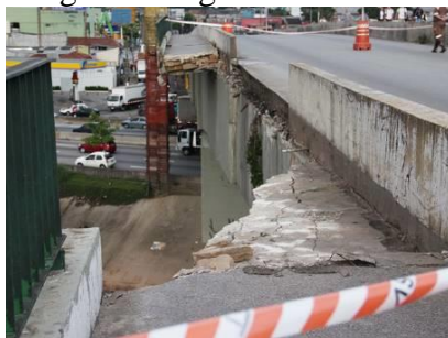
Figura 4- Mureta de proteção que ruiu
