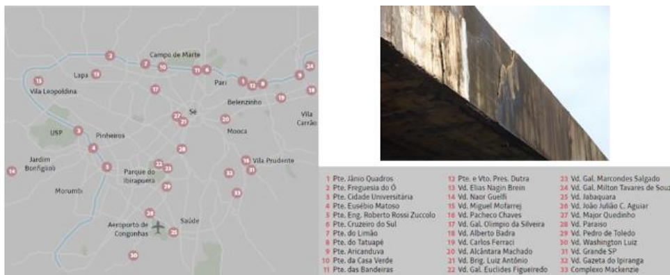
Figura 5 - Relação de pontes e viadutos em São Paulo com problemas.
