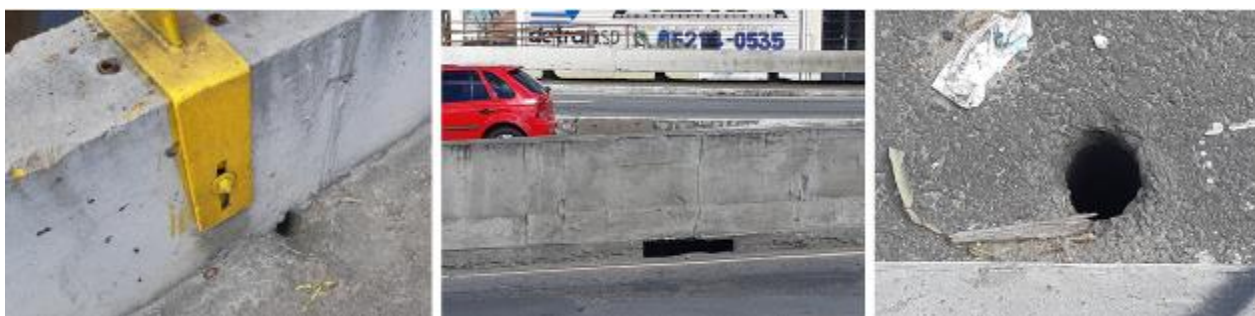
Figura 6 – Patologias pela falta de compatibilização de projetos (Acervo do autor)
