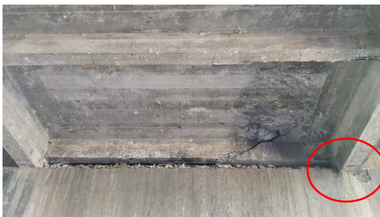
Figura 5 – Rachadura na laje e transversina e deslocamento vertical na longarina.
