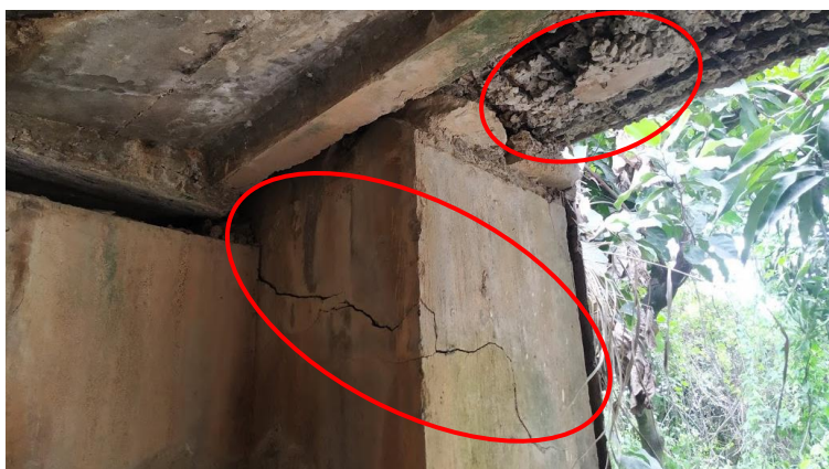
Figura 10 – Rachadura no encontro da ponte.
