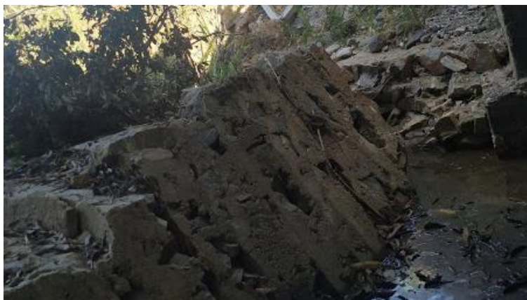
Figura 6 – Contenção do encontro caída.
