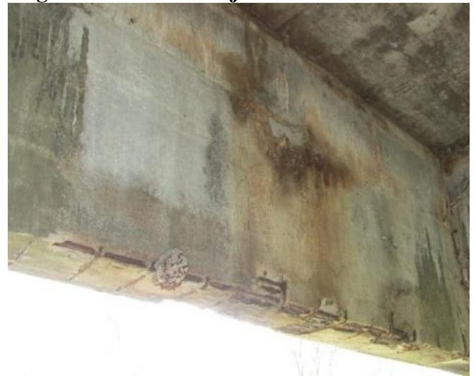
Figura 11 – Dano na viga T ou I de concreto armado.
