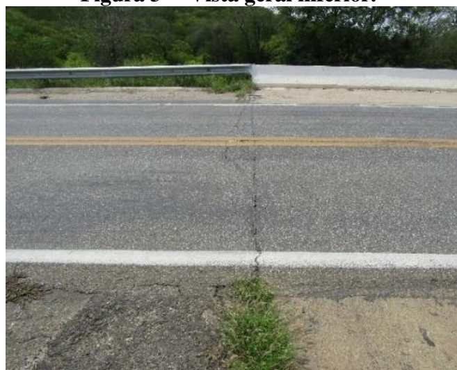
Figura 5 – Dano na junta de dilatação.
