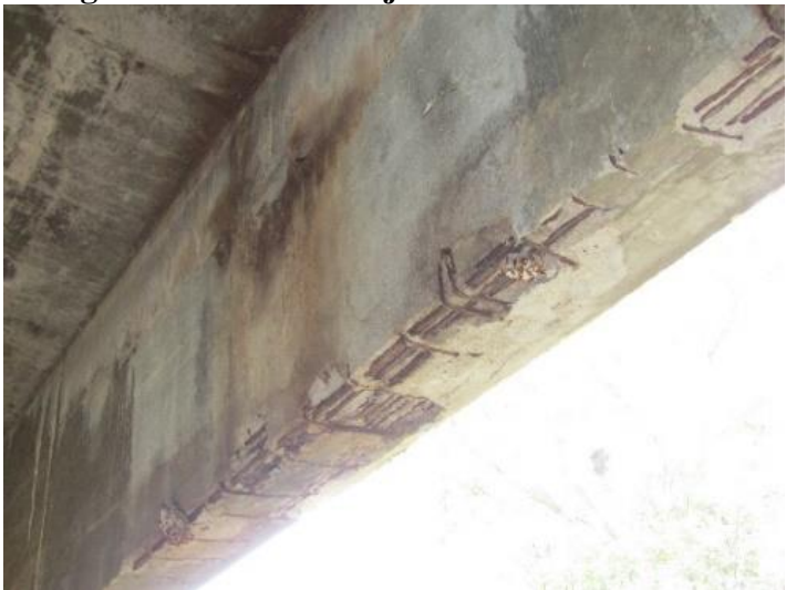
Figura 10 – Dano na viga T ou I de concreto armado.
