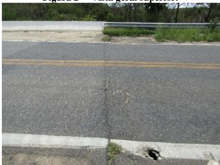
Figura 4 – Dano na junta de dilatação e no pavimento asfáltico.
