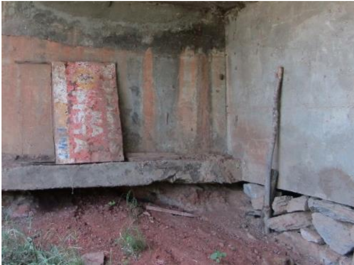
Figura 6 – Dano no encontro cortina de concreto armado.
