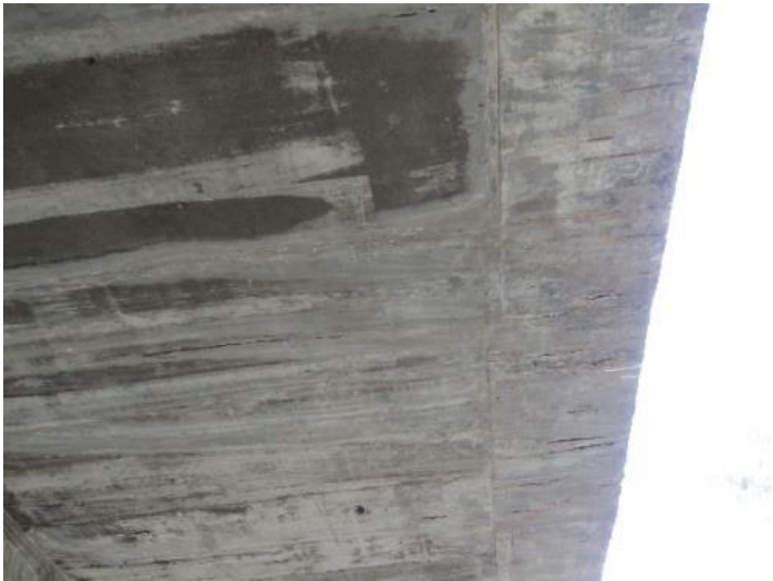
Figura 8 – Dano na laje de concreto armado.
