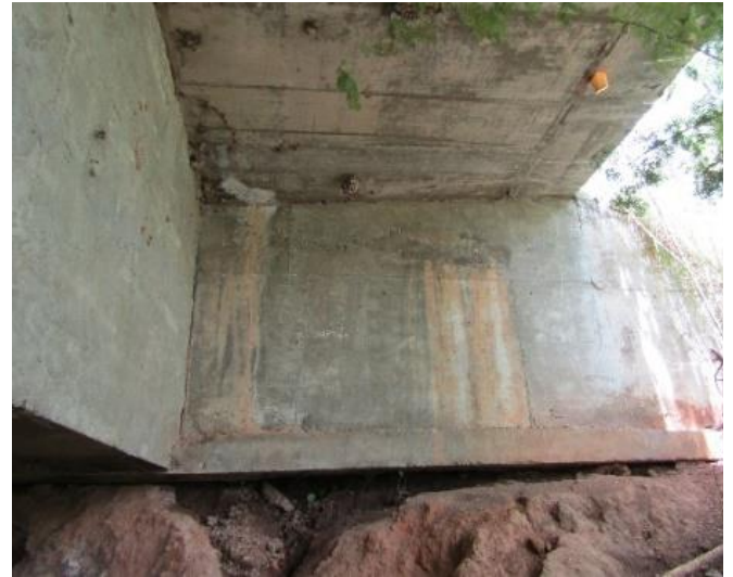
Figura 7 – Dano no encontro cortina de concreto armado.
