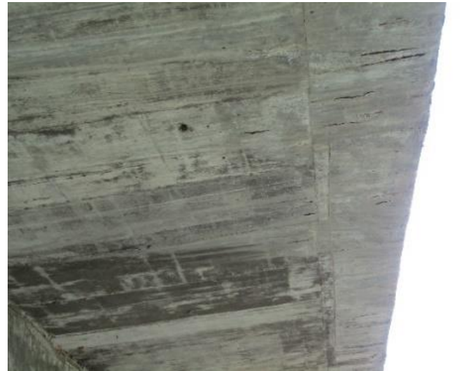
Figura 9 – Dano na laje de concreto armado.
