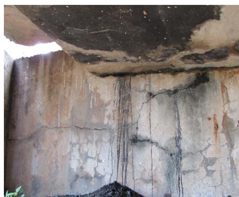
Figura 11 – Fissura, infiltração e Manchas de fogo (Fonte: SGO, 2019).
