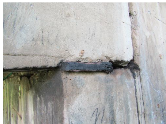
Figura 5 – Aparelho de apoio danificado (Fonte: SGO, 2019).
