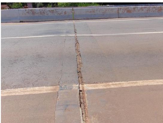
Figura 4 – Junta de dilatação danificada (Fonte: SGO, 2019).
