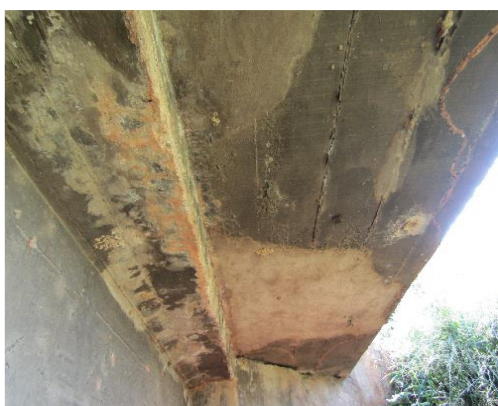
Figura 10 – Lixiviação e mancha de carbonatação (Fonte: SGO, 2019).
