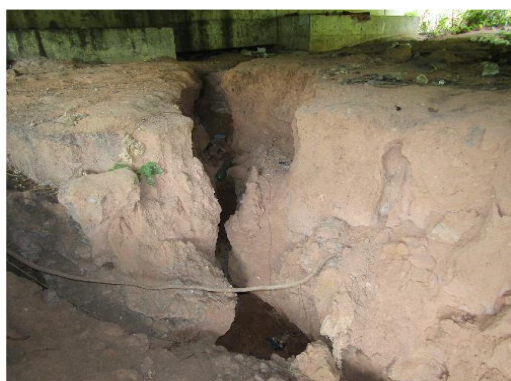
Figura 7 – Erosão do talude de aterro (Fonte SGO, 2019).
