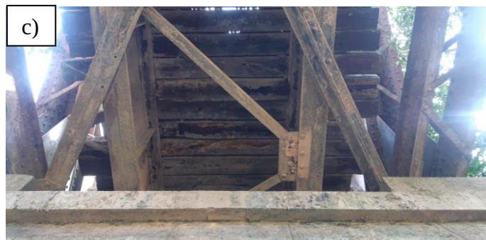
Figura 8 – Degradações pontuais no dormente do Pontilhão em decorrência da presença de insetos xilógrafos.
