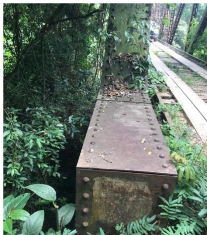
Figura 4 – Observância de matéria orgânica nos interstícios estruturais do Pontilhão.
