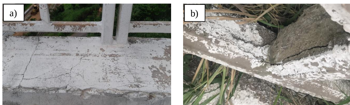
Figura 1 – Manifestação de fissuras na Ponte Torta.
