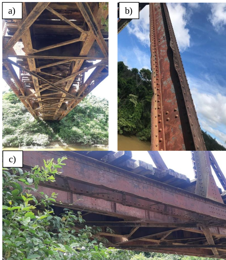
Figura 3 – Manifestação de oxidação em elementos estruturais do Pontilhão.
