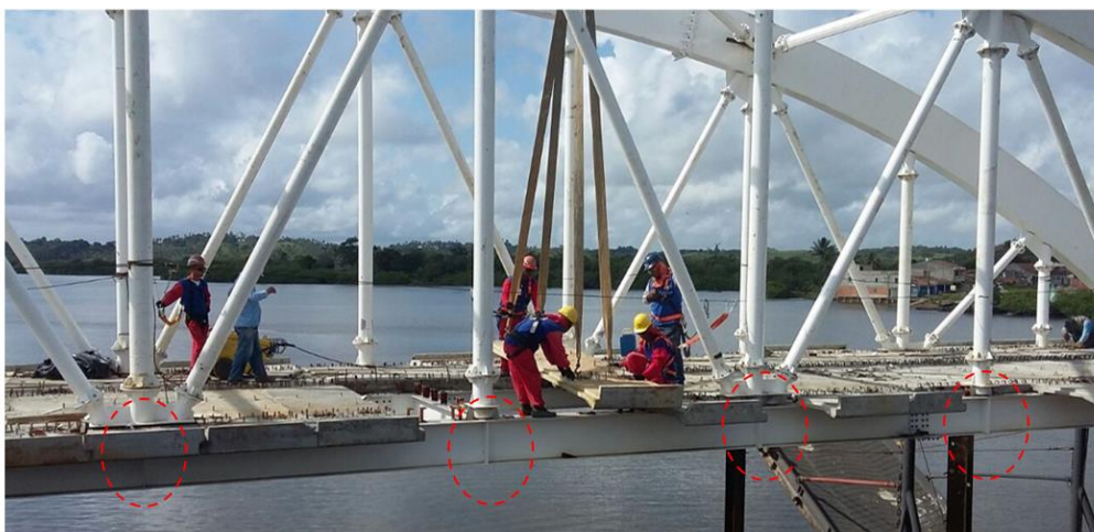
Figura 6 – Seções críticas da viga longarina quanto a ocorrência de falhas por fadiga.
