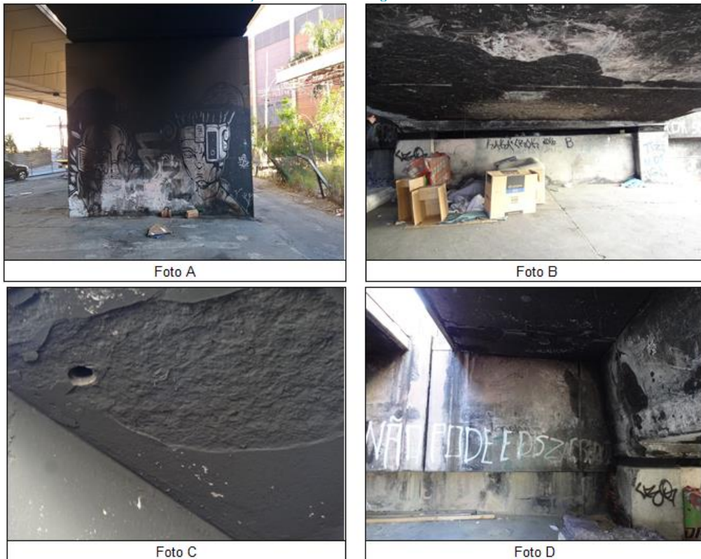
Figura 6 - Acúmulo de fuligem na parte inferior do viaduto (Autores)
