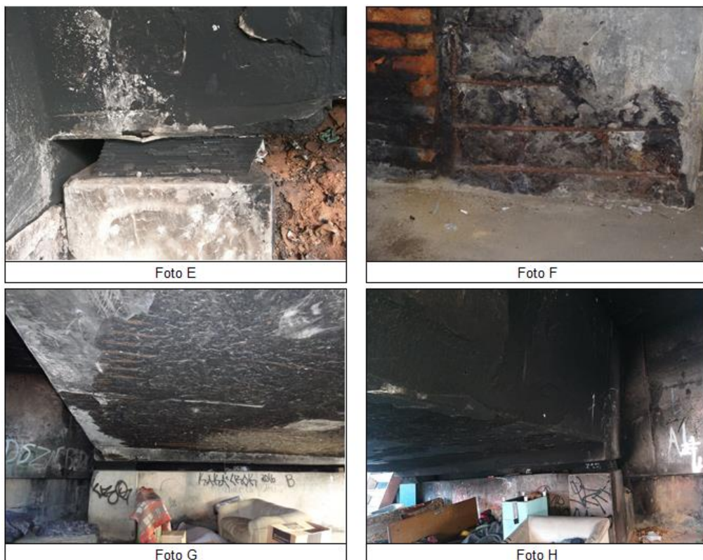
Figura 7 - Fenômeno Spalling e exposição da armadura de aço (Autores)
