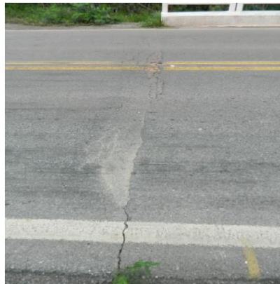
Figura 8 - Fissuras nas juntas.
