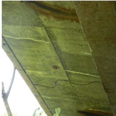
Figura 7- Fissuras com deslocamento do concreto em tabuleiro de ponte.
