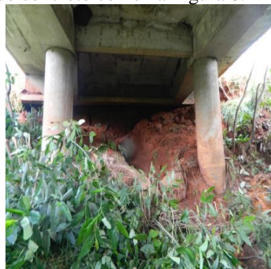
Figura 6 – Processo erosivo no aterro.
