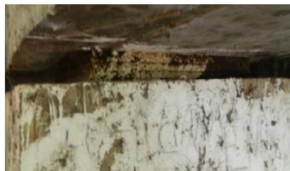
Figura 9 - Aparelho de apoio danificado.
