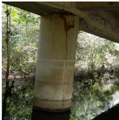
Figura 5 – Pilar fissurado com imperfeição geométrica.
