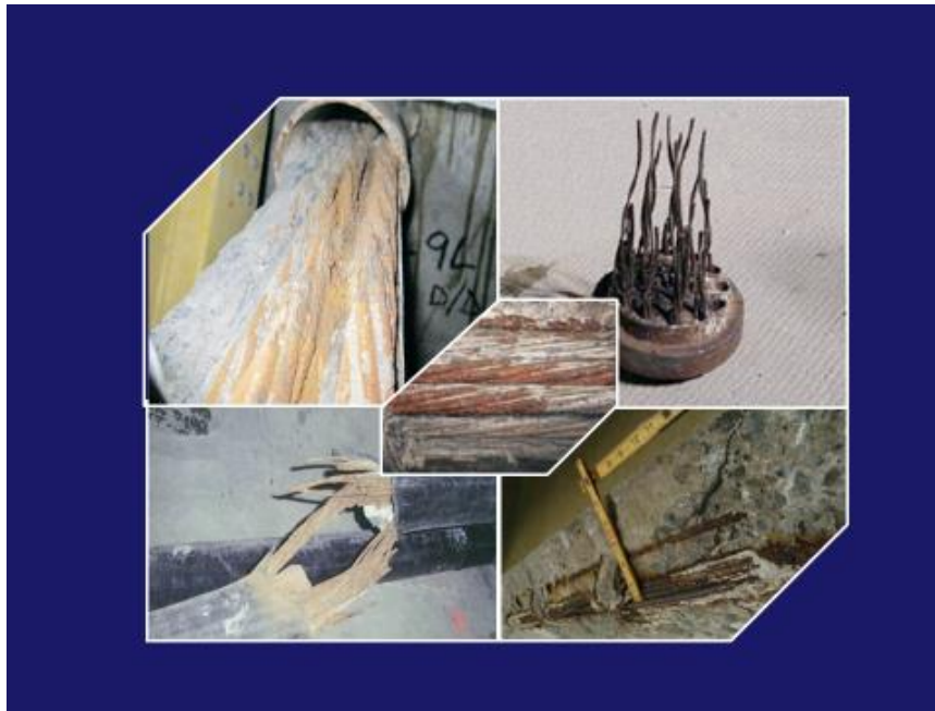
Fig. 3: Cabos Pós-Tensionados com Problemas Sérios de Corrosão, Situação Comum de ser Encontrada e Pontes e Estruturas em Operação.
