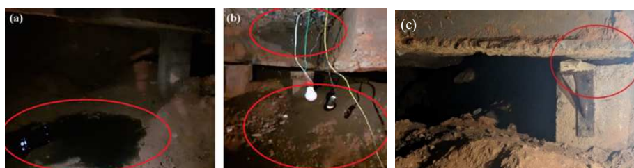
Figura 5 – (a) e (b) Vazamentos encontrados próximos às fundações. (c) Detalhe de um dos pilares que se desconectaram da laje inferior da casa. Fonte: Autoras (2020)
