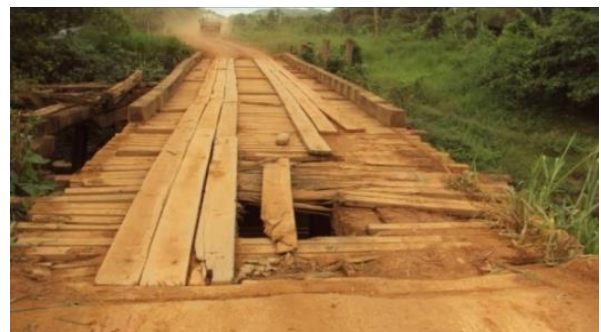
Figura 13 - Ponte Provisória com deslizantes e pranchetas danificadas, e ausência de guarda corpo e guarda rodas, 2013 (DNIT, 2019).
