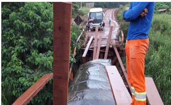
Figura 10 - Colapso de uma ponte de madeira na Rod. Transamazônica, KM 94, em janeiro de 2019 (ADMS, Felype / O Liberal, 2019).
